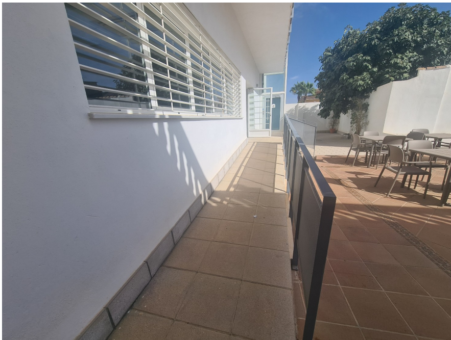
Rampa del patio del Hogar del Pensionista sin doble pasamanos, zócalo y señalización
