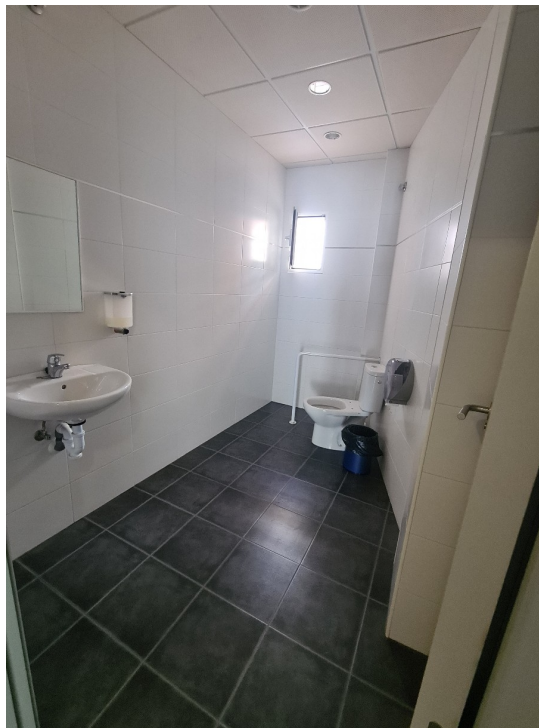
Aseo adaptado parcialmente en planta baja
