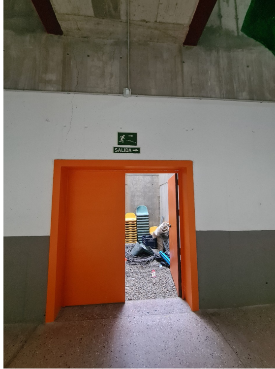
Patio exterior donde se va a acondicionar el aseo-vestuario-ducha accesible en planta sótano
