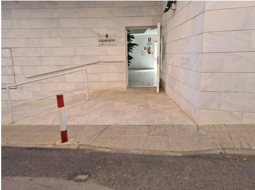
Acceso a los Juzgados desde Calle Marañona donde falta doble pasamanos
