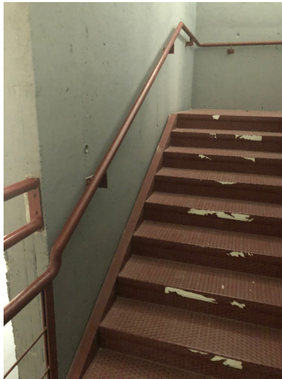
Escaleras interiores sin doble pasamanos
