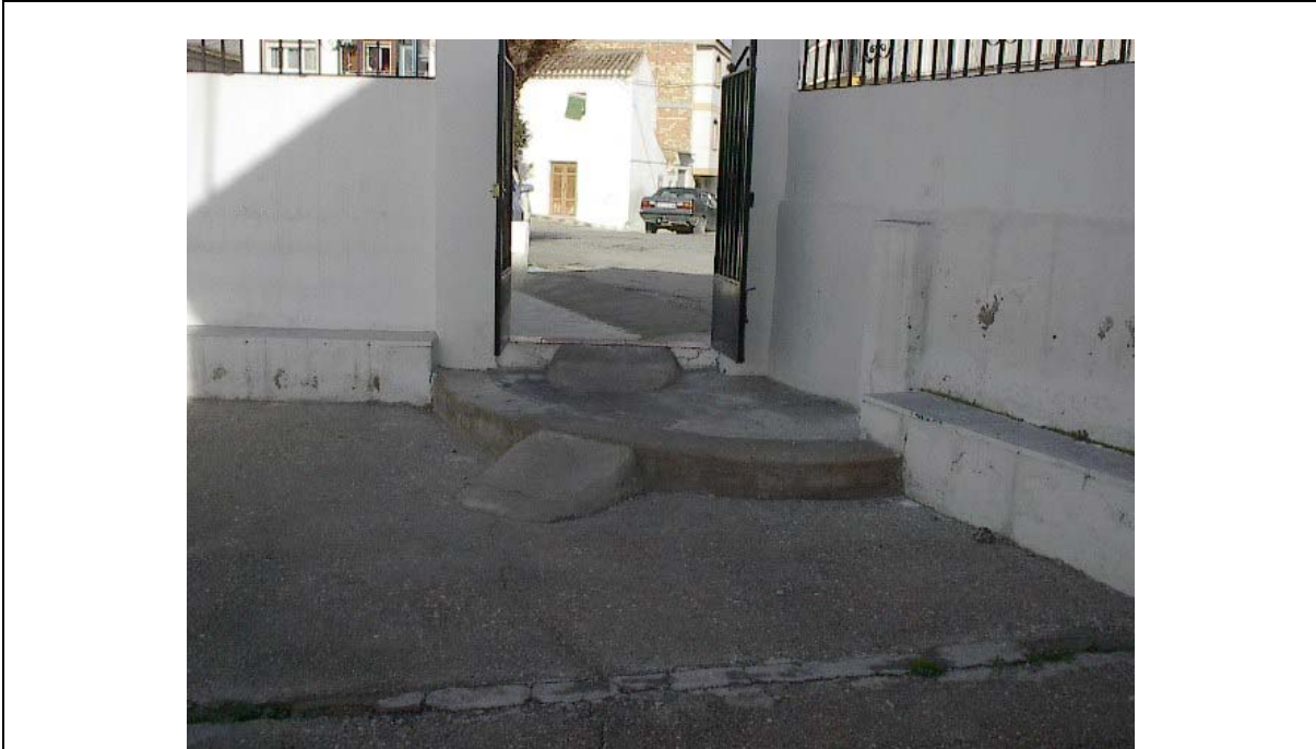
Foto 1 Acceso con escalones y rampas mal planificadas.
