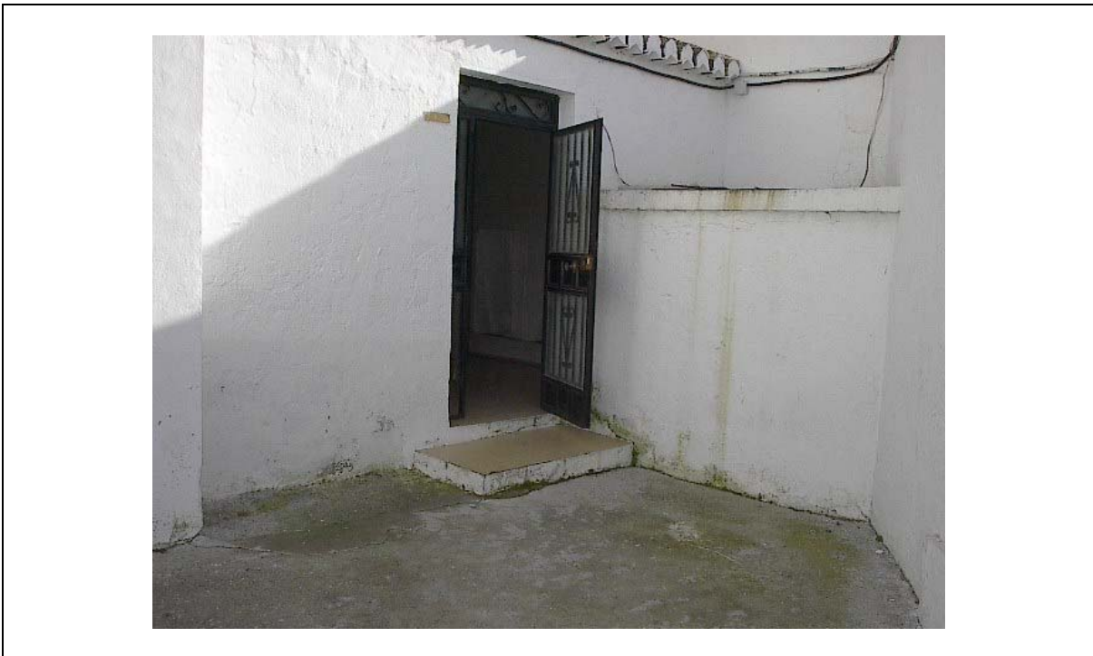
Foto 2 Aseos exteriores no adaptados y con escalones para el acceso.
