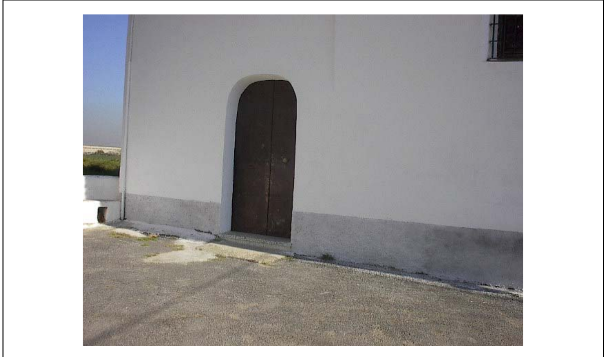
Foto 1 Acceso con escalón
