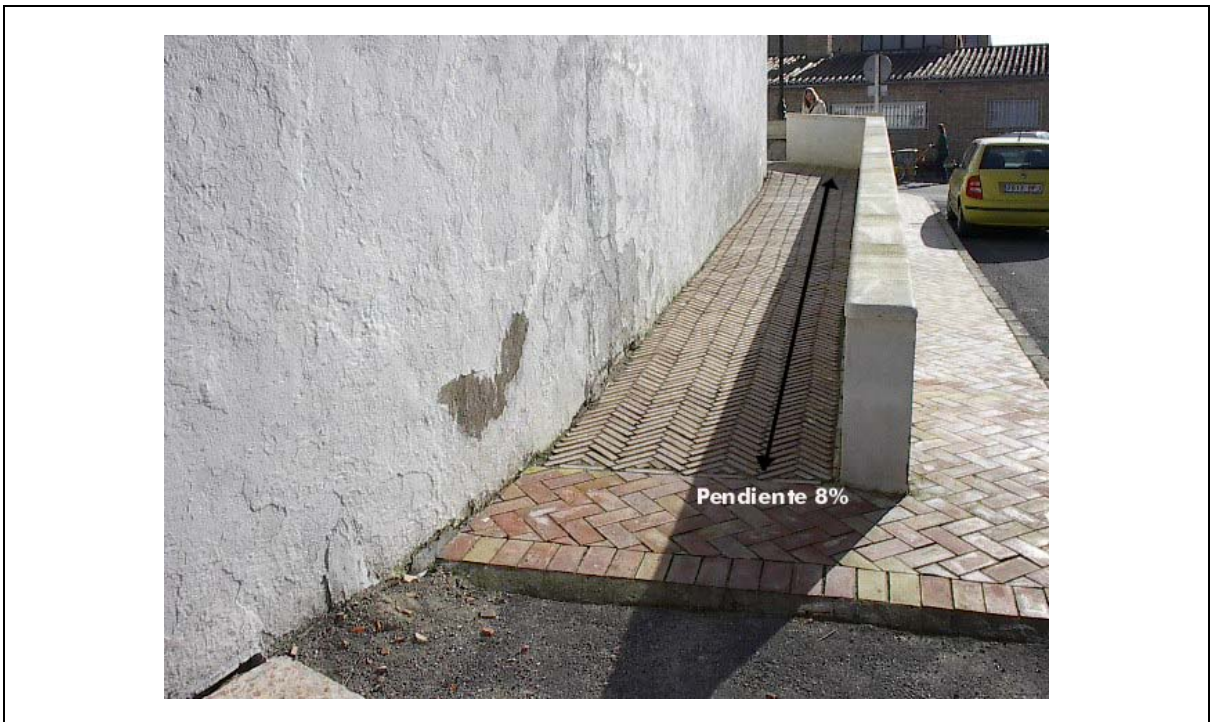
Foto 2 | RAMPA DE ACCESO Pasamanos sólo en un lado, altura 78 cm.
