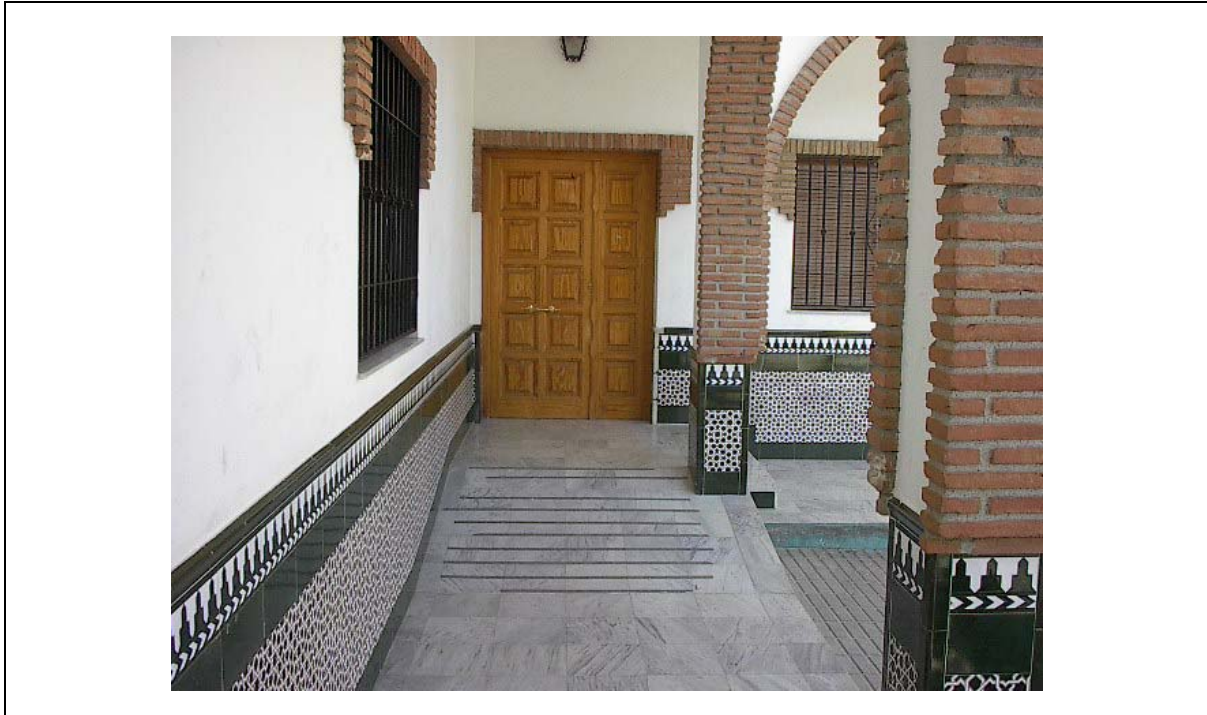
Foto 7 Rampa sin pasamanos
