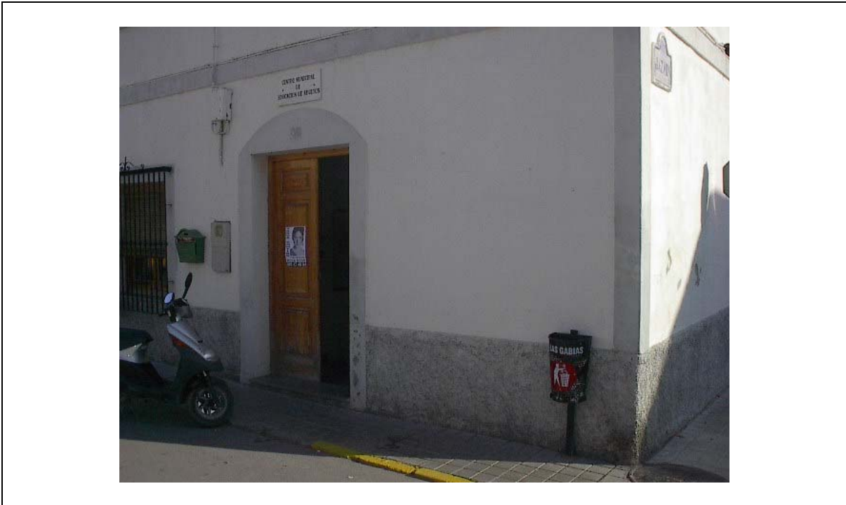
Foto 1 PUERTA DE ACCESO DOBLE Con escalón de acceso.
