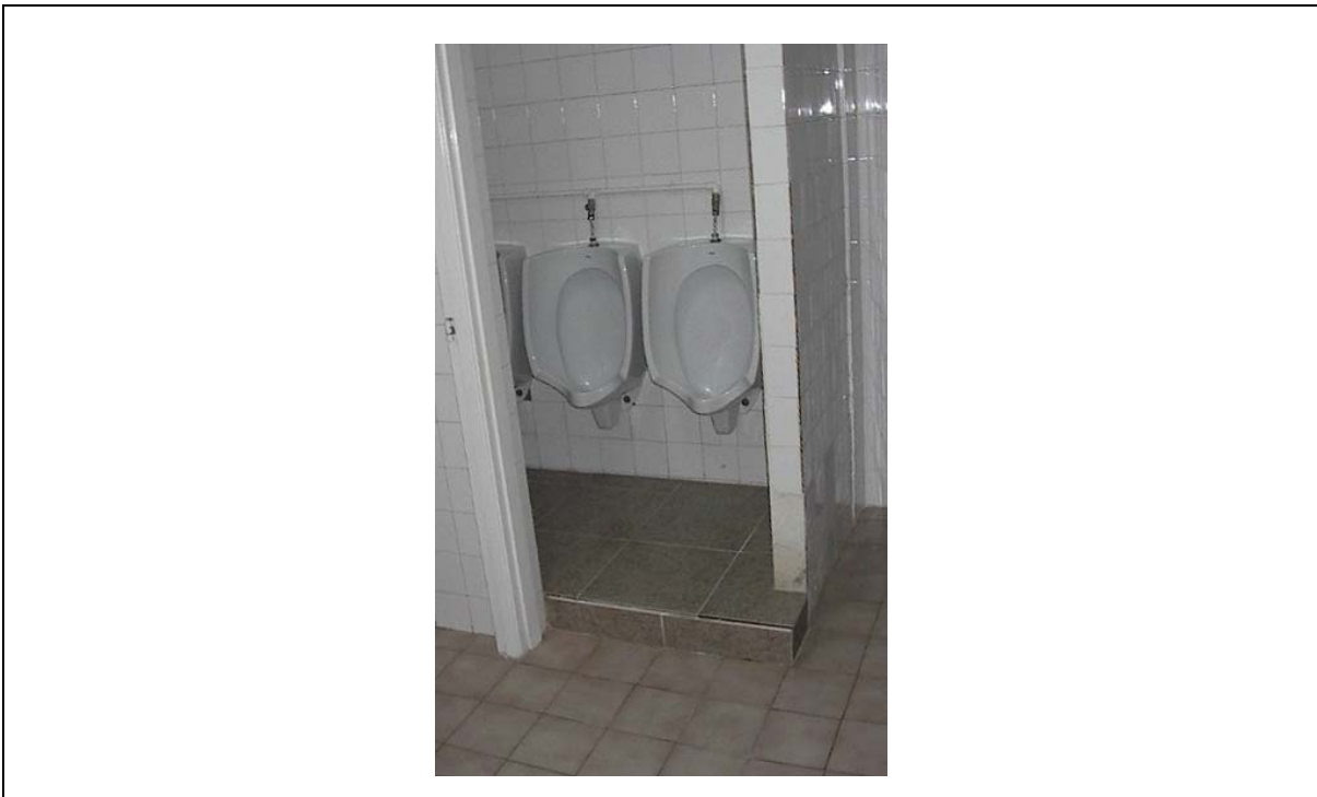
Foto 4 Aseos no adaptados y con desniveles con escalones
