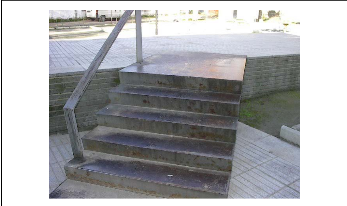
Foto 5 Escaleras. Huella 33 cm. Contrahuella 18 cm. Altura del pasamanos 55 cm.
