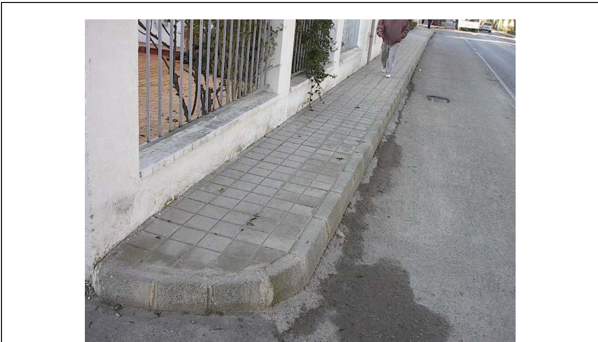
Foto 2 Estrechamiento de acera < 1,2 m. Sin vado de acceso
