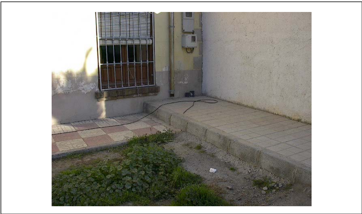
Foto 4 Desnivel aislado entre aceras de 20 cm.
