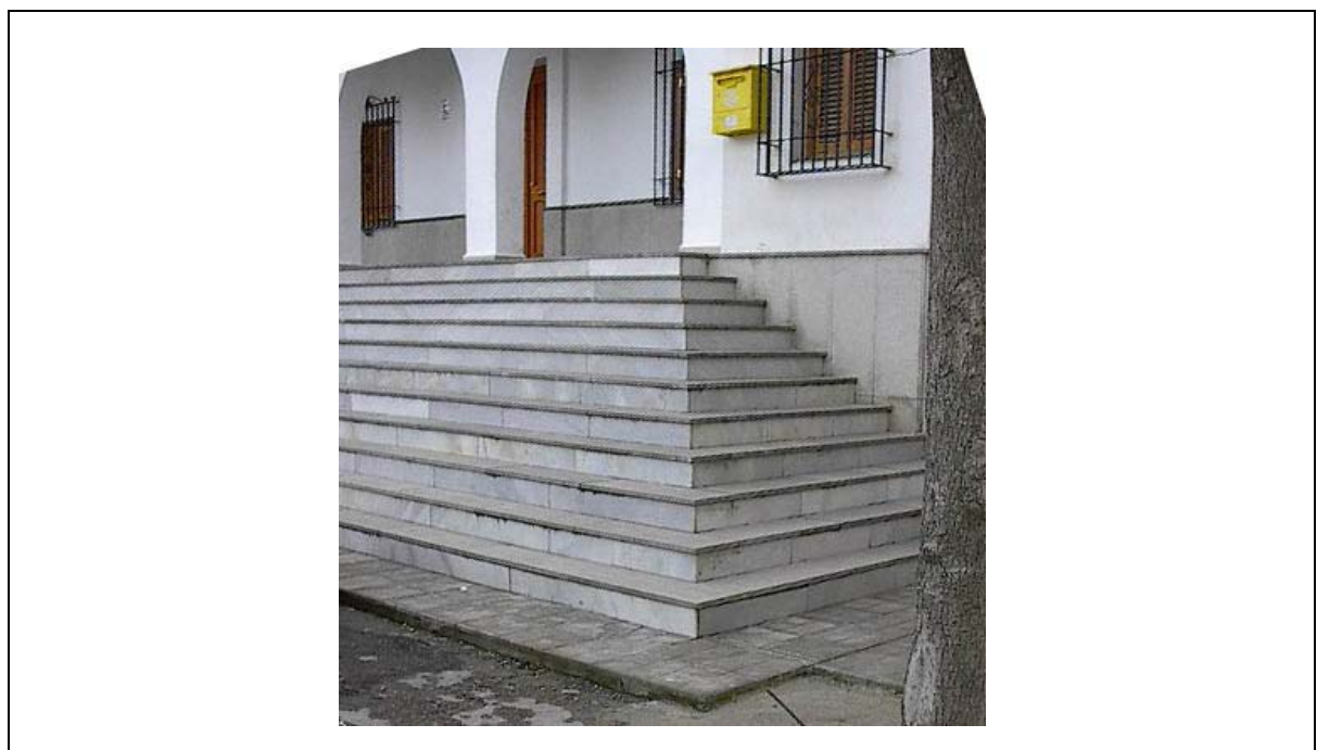
Foto 4 ESCALINATA DE ACCESO AL AYUNTAMIENTO Buzón no accesible Sin rampa alternativa que salve el desnivel
