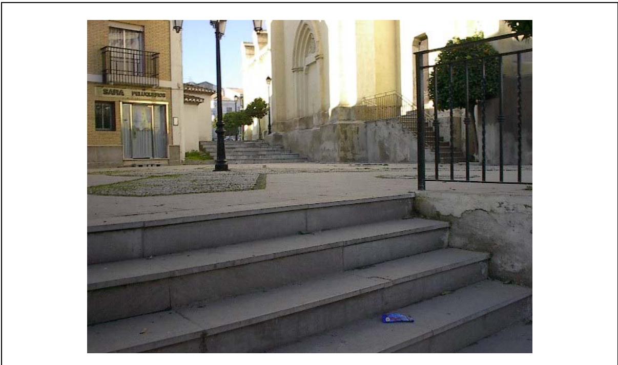
Foto 2 PLAZA DE LA SACRISTÍA Escaleras: Huella 33cm., contrahuella 18 cm. Ancho 3m. Sin pasamanos
