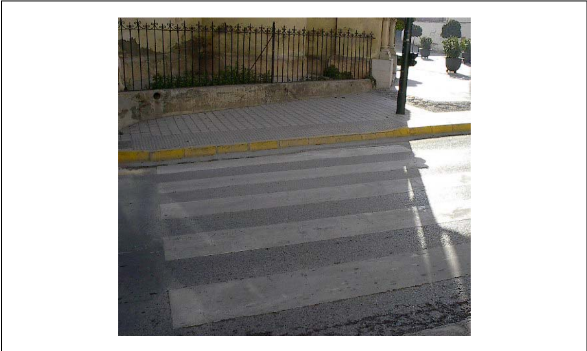
Foto 5 Paso de peatones sin vado
