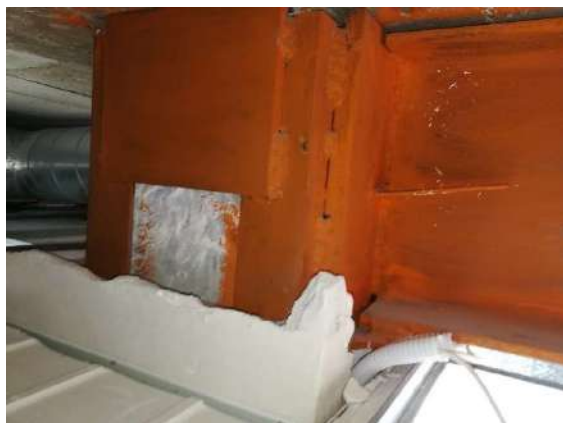
Figura 20.- Detalle refuerzo metálico en cabeza pilar PH3.
