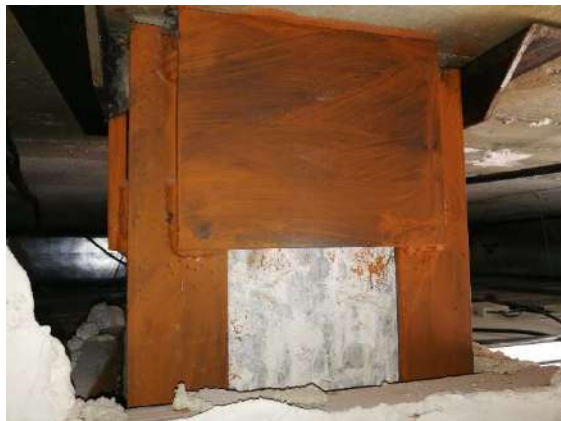
Figura 23.- Detalle refuerzo metálico en cabeza pilar PH4.
